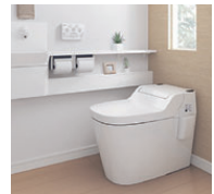
本体・機能便座 手洗器 換気扇
